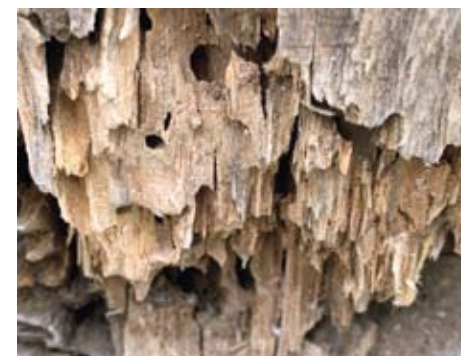
Mitrumā satrupējusi koka konstrukcija.
